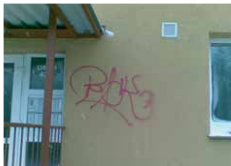
Sam. 422, poškozená fasáda domu
