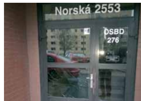
Sam. 276, rozbité sklo vchodových dveří
